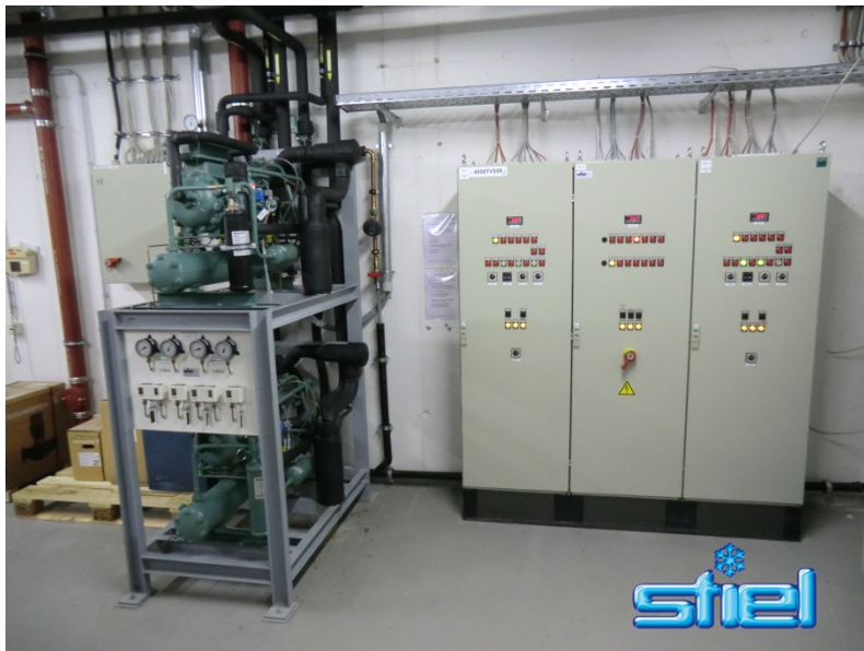
Abbildung 2 Kältemaschine mit Schaltschrank © Stiel
