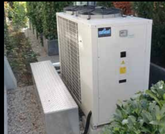
Kaltwassersatz im Außenbereich aufgestellt
